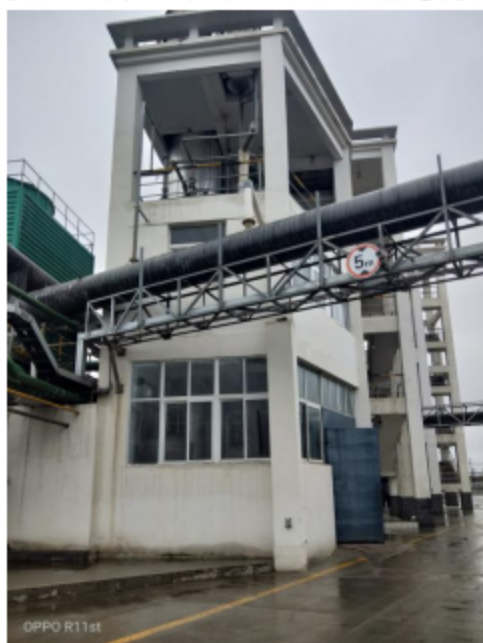
三效蒸发装置
