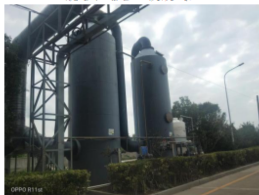
两级水洗装置（污水处理区加盖收集无组织废气）
