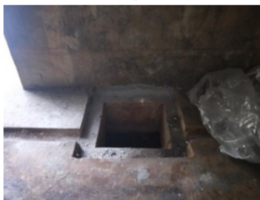
403 危废仓库收集池
