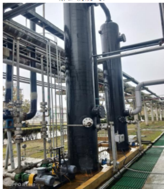
一级水洗+一级碱洗装置（稻丰散车间酯化、脱溶、缩合工段废气）
