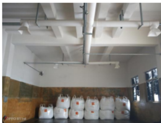
403 危废仓库废气收集装置
