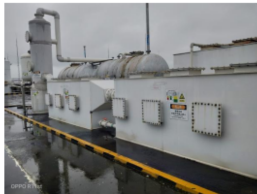
二级水洗+一级酸吸收装置（乐果 3#车间胺解工段废气）
