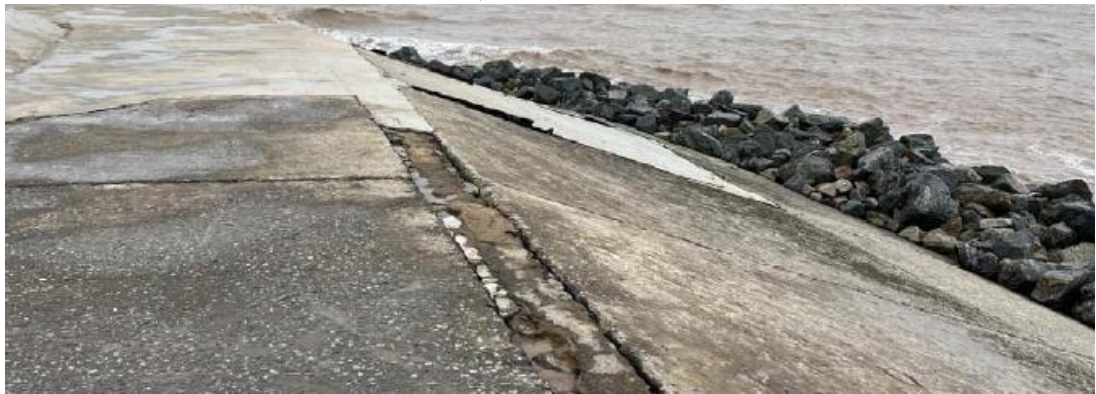
图 2-7 北港堤圆头南侧护坡现状
