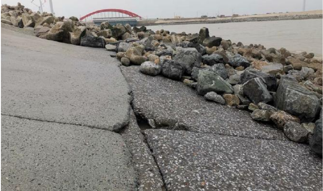
图 2-11 南港堤圆头北侧护坡开裂、砼面层剥落
