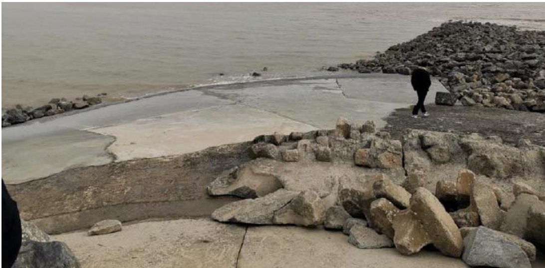
图 2-9 南港堤圆头护坡开裂、扭王块体脱落
