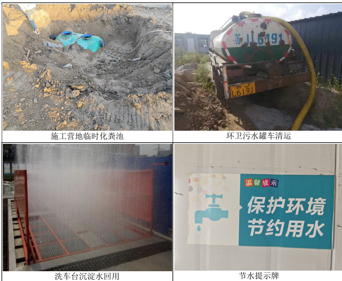
图 5-4 施工期采取的水污染防治措施
